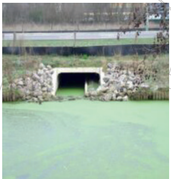
Duiker provinciale weg voorzien van loopplank
